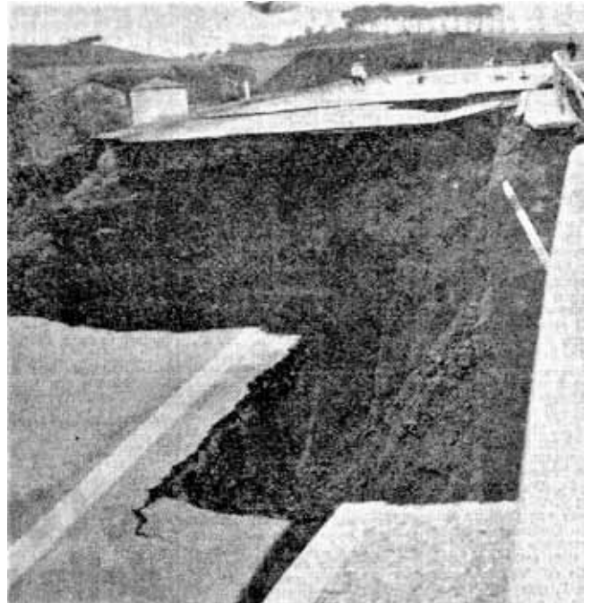
Il ponte del G.R.A. crollato (foto tratta da Il Messaggero di Roma)
